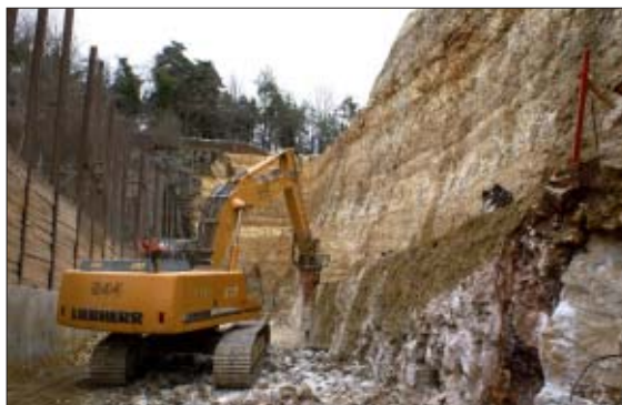
Excavation finale de la falaise. Depuis le portail sud et sur les 40 premiers mètres, le nouveau tunnel ne sera distant que de 3 à 4 mètres du tunnel existant.
