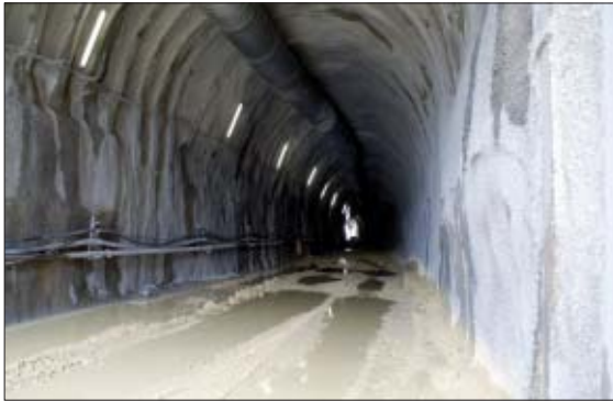
Situé dans le calcaire, le percement du tunnel nord, qui a débuté en septembre 2008 au moyen d'une haveuse, est aujourd'hui terminé.
